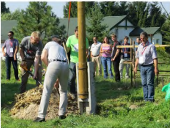
Рисунок 21. Деревянная часть опоры на 20 см выше уровня земли.
